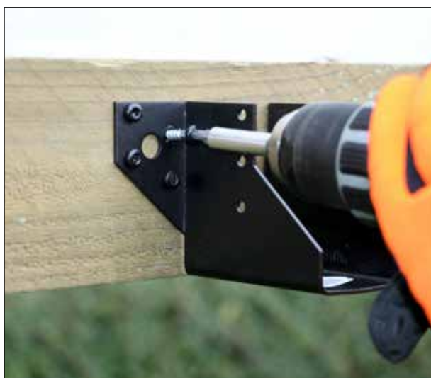
Suporte SAE-PB preto instalado com parafusos CSA-PB
