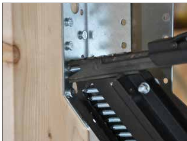
Suporte SAE instalado com CNAPC34
